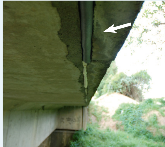
Photo 19 : Cavité bouchée à l'aide de gaine d'isolation de tuyau de chauffage (Source : S. Bareille)
