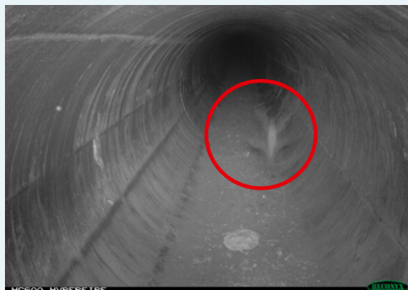
Photo 125 : Passage de Chiroptère dans une buse de 1 200 mm de diamètre et 53 m de long, réalisée sous l'A10. Le suivi réalisé montre plusieurs franchissements par les Chiroptères (Source : LPO France/Vinci Autoroutes/réseau ASF - 2012)
