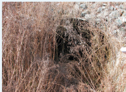
Photo 52 : Entrée d'une buse obstruée par la végétation (Source : L. Arthur - Muséum Bourges)
