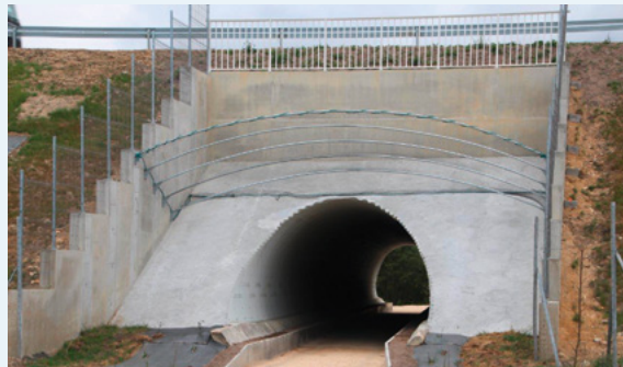
Photo 73 : Exemple de dispositif mis en place sur l'autoroute A71 (Source : Ingérop/Cofiroute)
