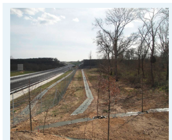
Photo 63 : Plantation, jusqu'à l'ouvrage, d'une double haie de guidage le long de l'autoroute A65 (Source : A Liénor/Eiffage)
