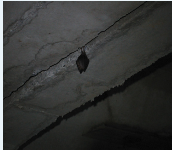
Photo 131 : Rhinolophe observé à l'intérieur de la structure (Source : Nature Midi-Pyrénées/CEN Midi-Pyrénées/Vinci Autoroutes/réseau ASF - 2011)
