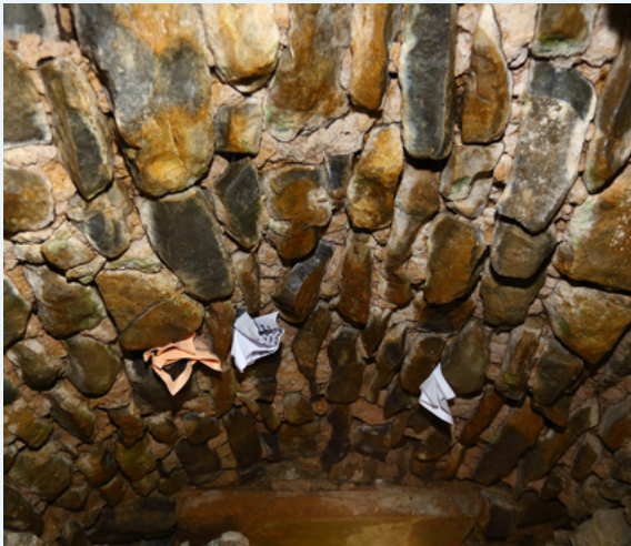
Photo 18 : Cavité bouchée à l'aide de papier (Source : Cerema - Est)
