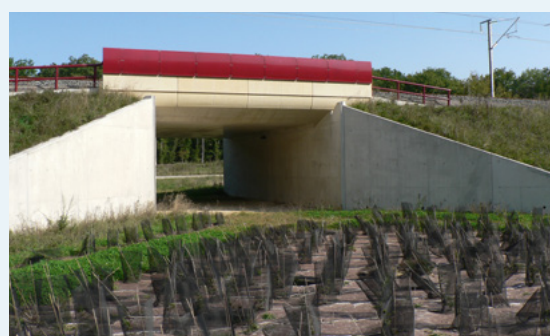
Photo 45 : LGV Est européenne - Passage Grande faune du Bois de Vigneule (Source : M. Gaillard - Néomys)
