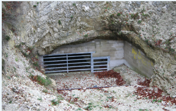
Photo 96 : Pose d'une grille à l'entrée de la cavité d'Allonne dans le cadre de la réalisation de la déviation Sud de Beauvais (RN31) (Source : CEN Picardie)
