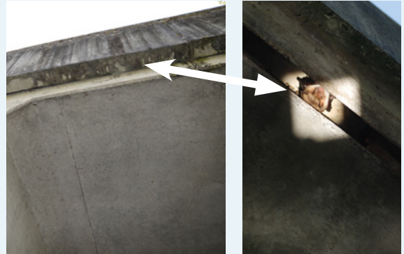
Photos 97 et 98 : Présence de Chiroptères entre la corniche et le tablier de l'ouvrage (Source : L. Arthur - MHN Bourges)
