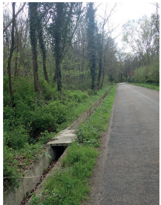
⑧ Dispositif de franchissement à sens unique de Larchant (77). Source : Cerema.
