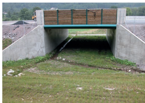
10 Passage inférieur permettant l'évacuation des eaux de ruissellement vers la pente. Source : Cerema.
