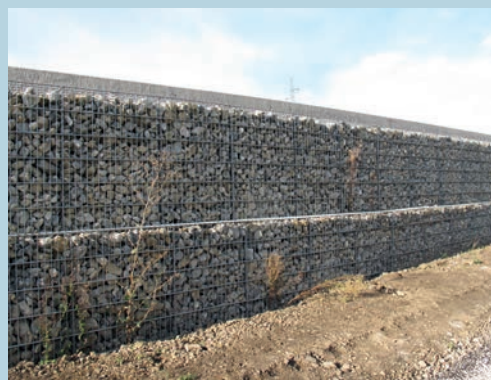
Mur en gabion le long de la RD16 (57). Source : Cerema.
