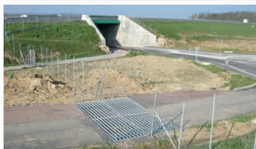
15 Grille canadienne installée pour empêcher la faune d'accéder à l'infrastructure depuis une voie secondaire. Source : Cerema.
