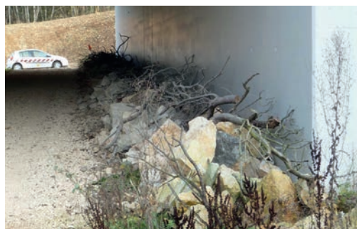
Passage inférieur équipé d'un andain. RN67 (52). Source : Cerema.
