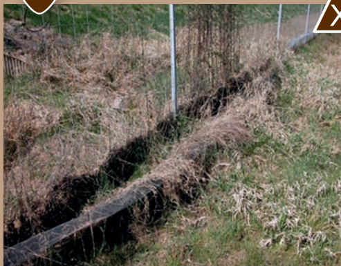
Clôture amphibie affaissée par le poids de la végétation. Source : Cerema.
