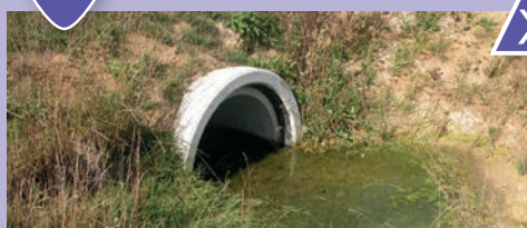
⑩ Les passages petite faune situés sous le terrain naturel et n'étant pas équipés d'une fosse de drainage sont souvent inondés et infranchissables. Source : Cerema.
