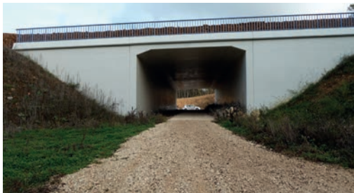
❶ Passage inférieur agricole et petite faune. Source : Cerema.
