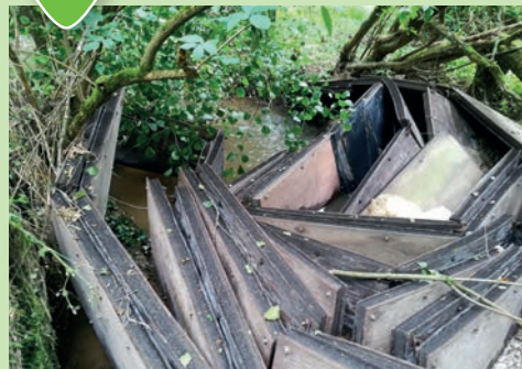
① Exemple d'un dispositif flottant expérimental installé dans une buse de 85 m emporté par le courant, suite à la rupture de l'ancrage sur la tête de buse. Source : Cerema.
