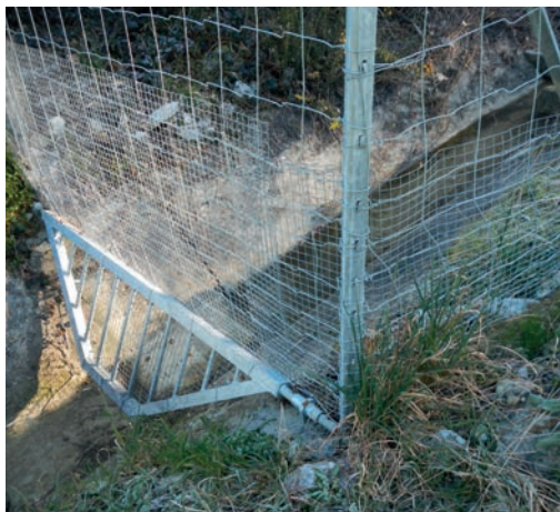
12 Exemple de dispositifs mis en place pour assurer la continuité des clôtures : grille amovible sur fossé. Source : Cerema.
