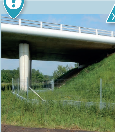
Mauvais raccordement de la clôture qui passe sous l'ouvrage et diminue l'espace disponible pour la faune. Source : Cerema.
