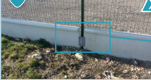
Bassin de traitement équipé d'une barrière béton avec des ouvertures laissant le bassin libre d'accès aux amphibiens. RD 1004 (Bas-Rhin). Source : Cerema.
