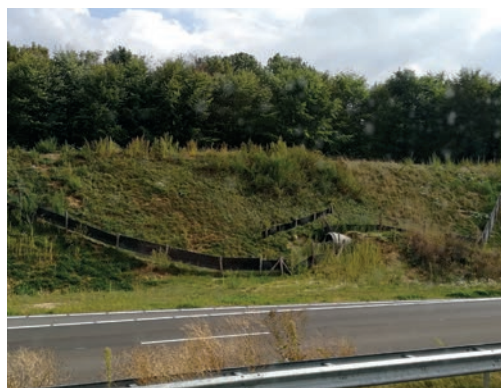
8 Exemple d'un passage petite faune dont la tête d'ouvrage est en pente et parallèle à l'infrastructure. Source : Cerema.
