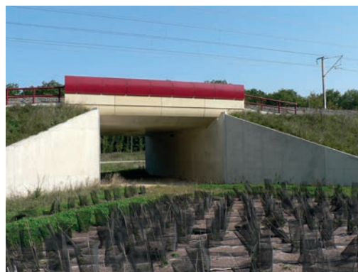
20 Passage inférieur du bois de Vigneule équipé de murs « en aile ». LGV Est européenne. Source : Néomys.
