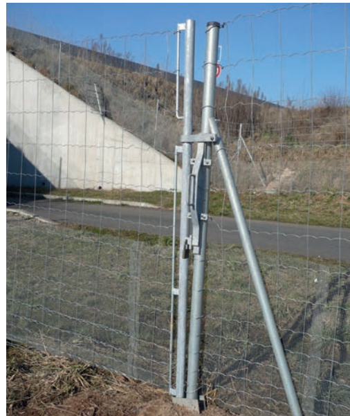
10 Passe américaine correctement clôturée mais ne présentant toutefois pas de seuil béton ni de barre ou câble de tension. Source : JBS Métallerie.
