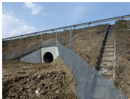
Passage petite faune de Velaux Autoroute A7 : vue sur le dispositif finalisé côté plateforme de poussage. Source : Vinci Autoroutes/Réseau ASF.
