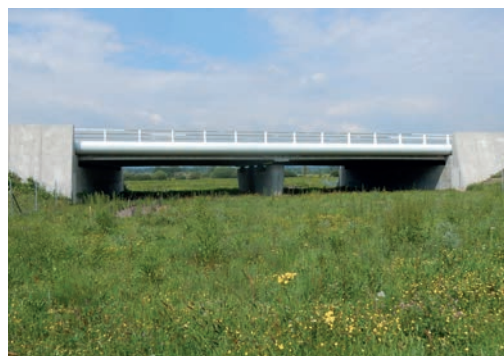
20 Ouvrage de décharge hydraulique fonctionnel pour la faune. Autoroute A304 (Région Grand Est). Source : Cerema.
