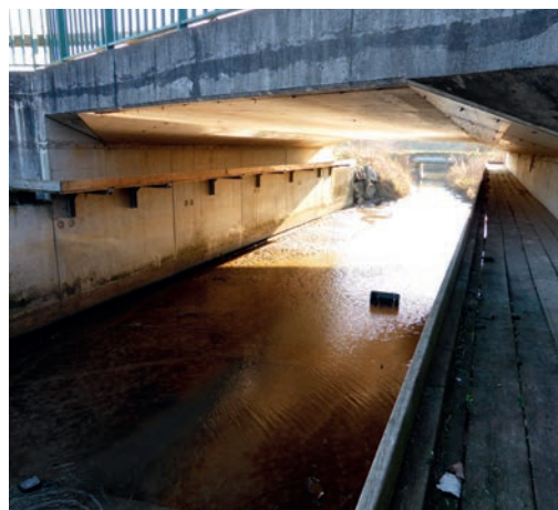
13 Vue sur une lisse en bois fixée sur une banquette en encorbellement. PNR Marais Poitevin. Source : Cerema.
